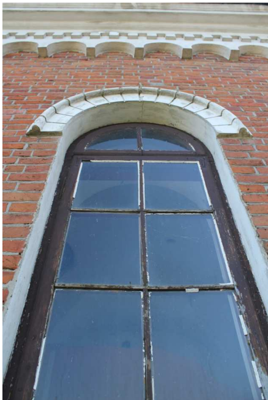
Fot.12. Zbliżenie na stolarkę okienną, widoczne ubytki w kitowaniu okien, łuszcząca się farba.
