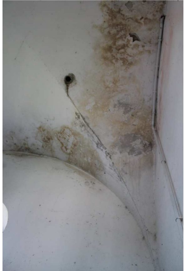
Fot.14. Sklepienie krzyżowe, widoczne plamy spowodowane nieszczelnościami w pokryciu części tarasowej.
