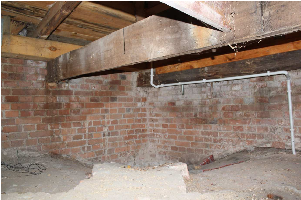
Fot.18. Przestrzeń nad sklepieniem. Widoczne mokre plamy spowodowane zaciekaniami wody opadowej spowodowane nieszczelnościami w pokryciu dachu tarasu. Widoczne również mokre elementy belek drewnianych konstrukcji tarasu.
