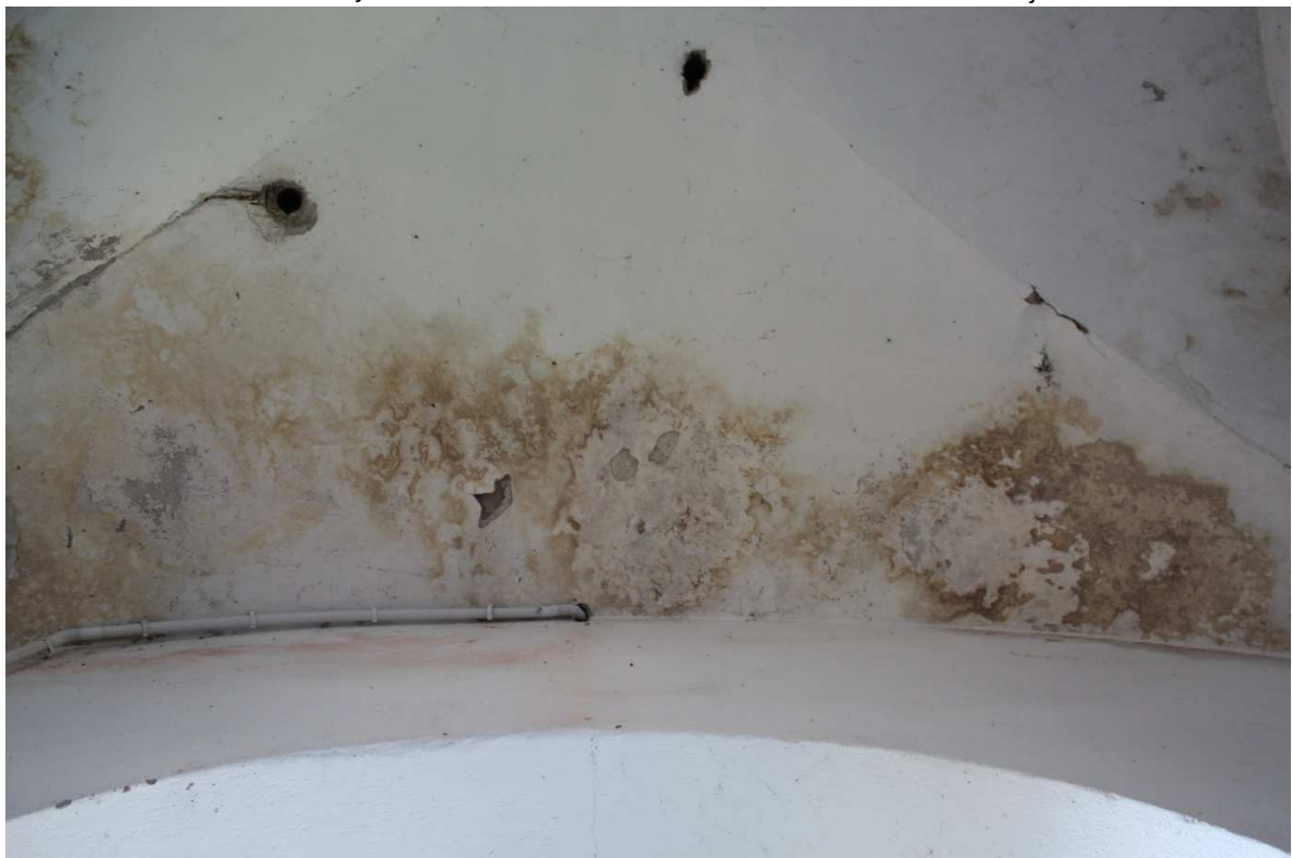
Fot.15. Sklepienie krzyżowe, widoczne plamy spowodowane nieszczelnościami w pokryciu części tarasowej.
