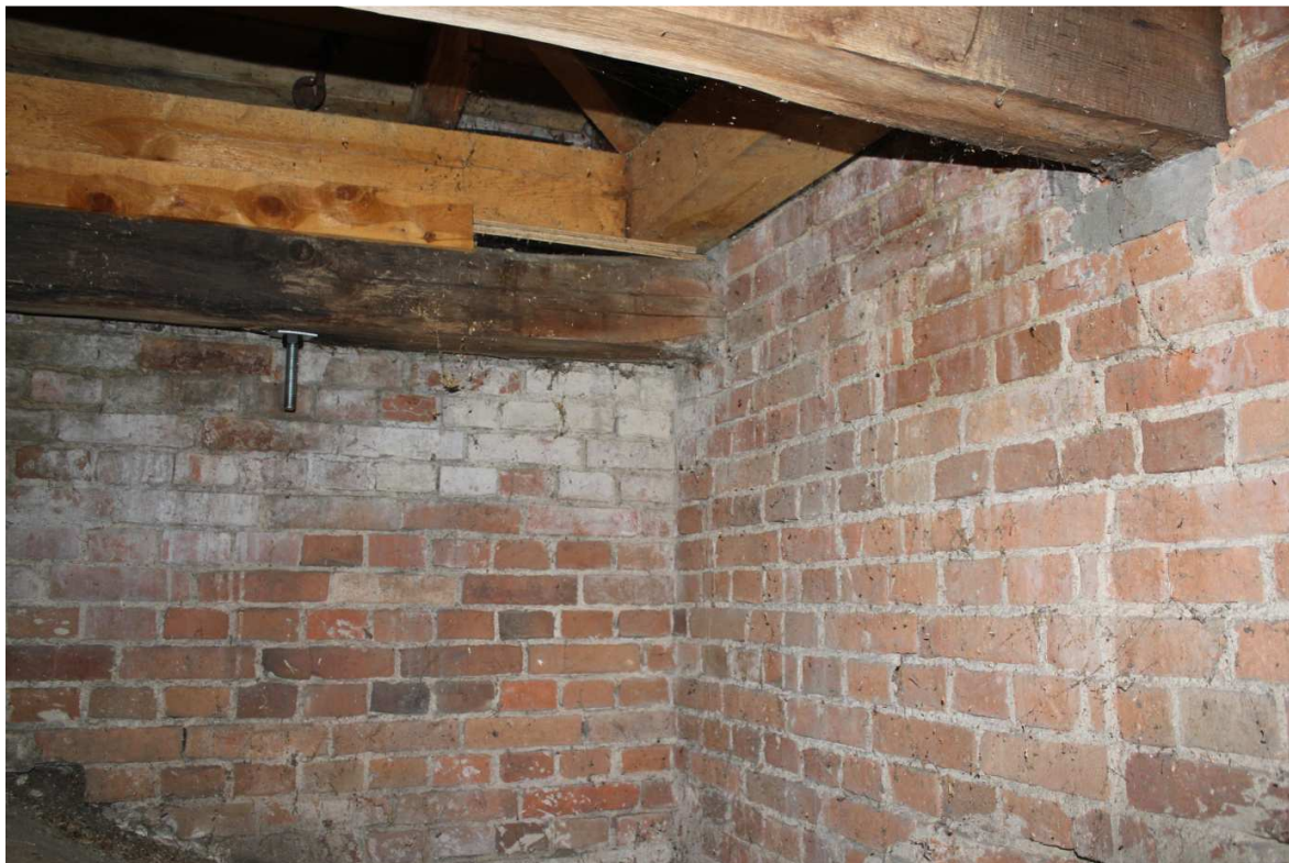
Fot.19. Przestrzeń nad sklepieniem. Widoczne mokre plamy spowodowane zaciekaniami wody opadowej spowodowane nieszczelnościami w pokryciu dachu tarasu. Widoczne również mokre elementy belek drewnianych konstrukcji tarasu.
