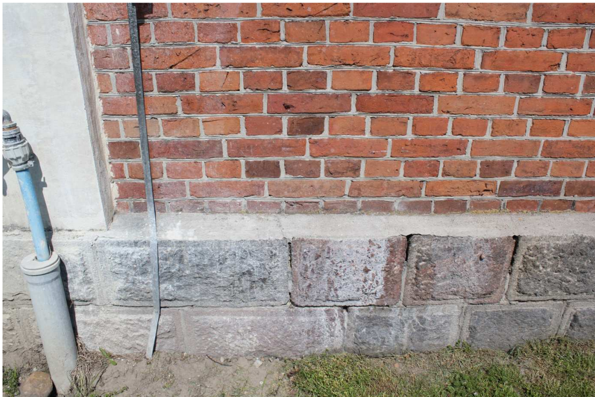
Fot.9. Widok na granitowy cokół, widoczne ubytki w spoinie, od góry widoczna warstwa spadkowa wykonana z zaprawy cementowej.
