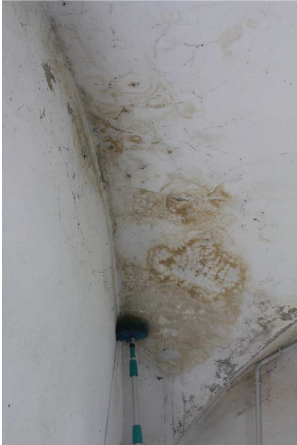
Fot.13. Sklepienie krzyżowe, widoczne plamy spowodowane nieszczelnościami w pokryciu części tarasowej.
