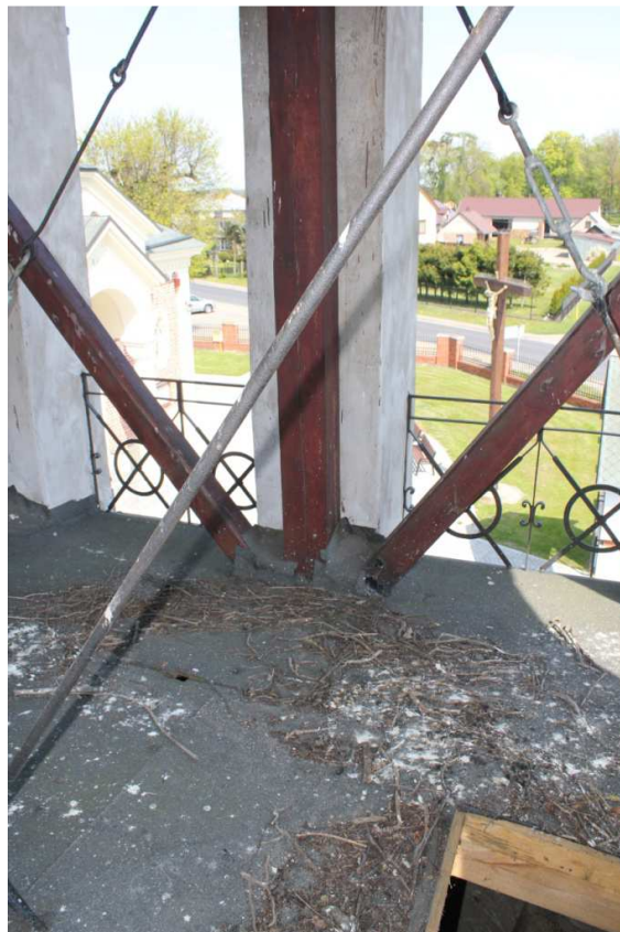
Fot.22. Poziom tarasu wyłożony papą, widoczne nieszczelności powodujące zamakanie.
