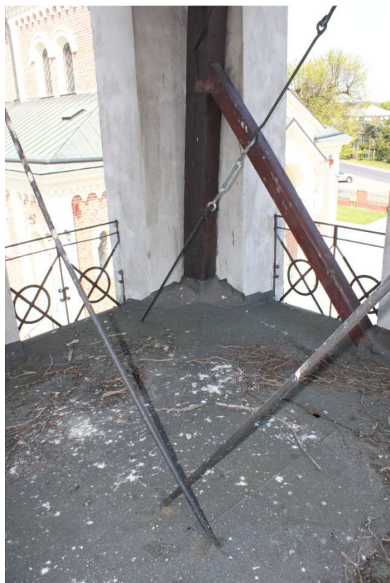
Fot.23. Poziom tarasu wyłożony papą, widoczne nieszczelności powodujące zamakanie.
