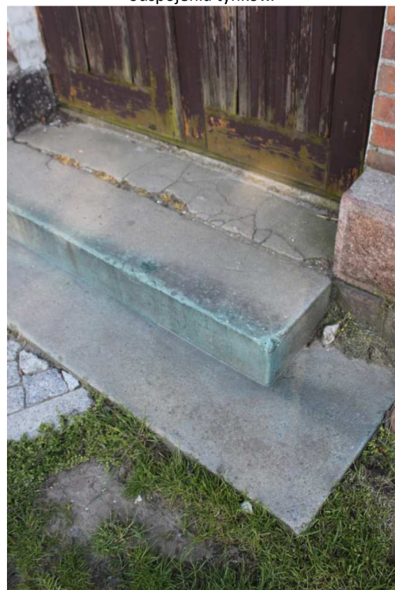
Fot.8. Widok na schody zewnętrzne, widoczne uszkodzenia oraz spękania wylewki cementowej między ościeżami.
